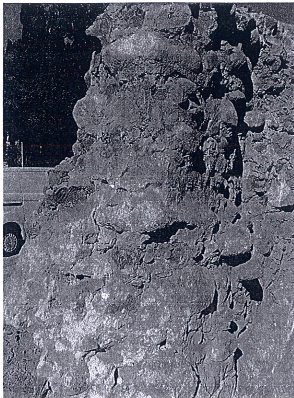
Fot. nr 5. Końcowy fragment muru od strony południowej. Widoczny zły stan techniczny elementu.
