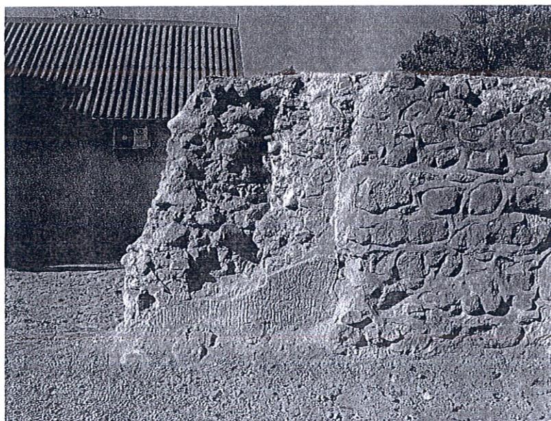
Fot. nr 6. Końcowy fragment muru od strony południowej. Przewężenie muru na odcinku ok 1,70 m. Widoczne ubytki w konstrukcji muru i degradacja zaprawy wapiennej.
