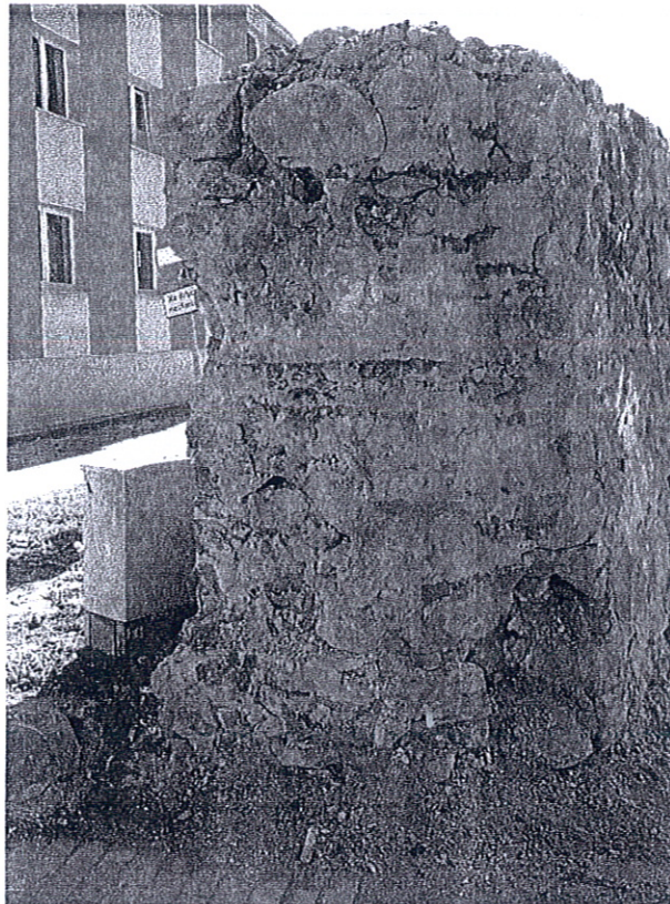
Fot. nr 7. Końcowy fragment muru od strony północnej. Widoczne ubytki w konstrukcji muru i degradacja zaprawy wapiennej.
