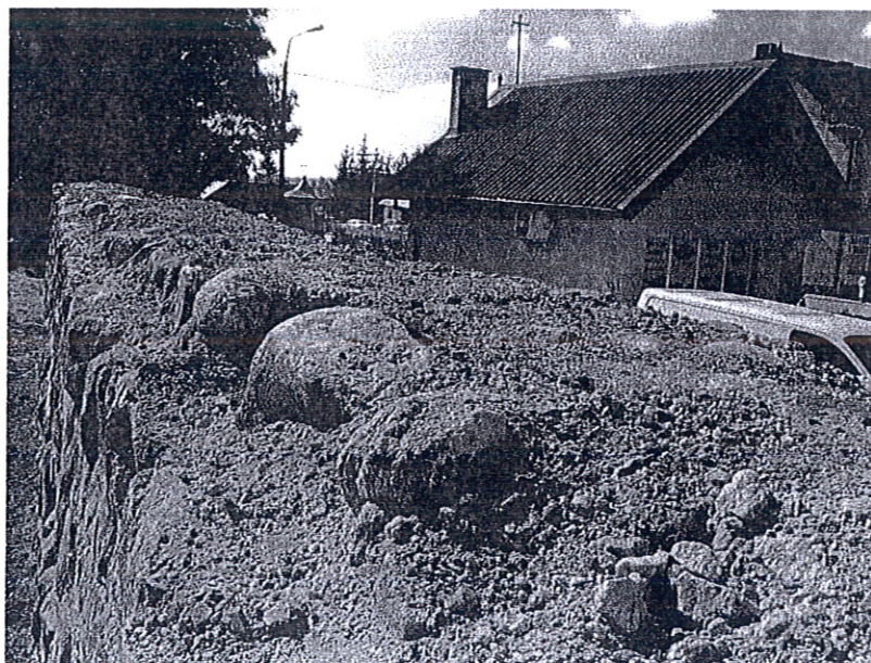
Fot. nr 10. Stan korony muru. Widoczne luźne kamienie oraz pozostałości gruzu po rozbiórce górnego fragmentu muru i sąsiadującego budynku. brak zabezpieczenia korony muru przed opadami.
