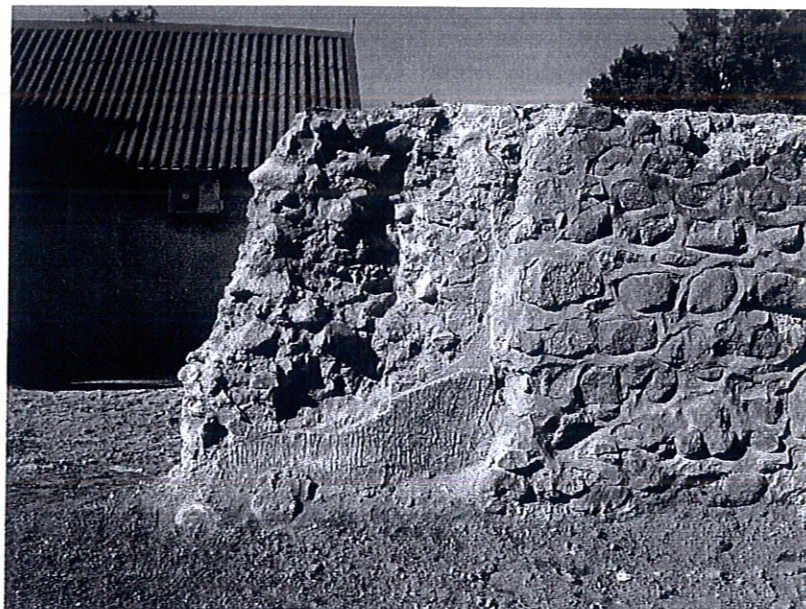
Fot. nr 6. Końcowy fragment muru od strony południowej. Przewężenie muru na odcinku ok 1,70 m. Widoczne ubytki w konstrukcji muru i degradacja zaprawy wapiennej.
