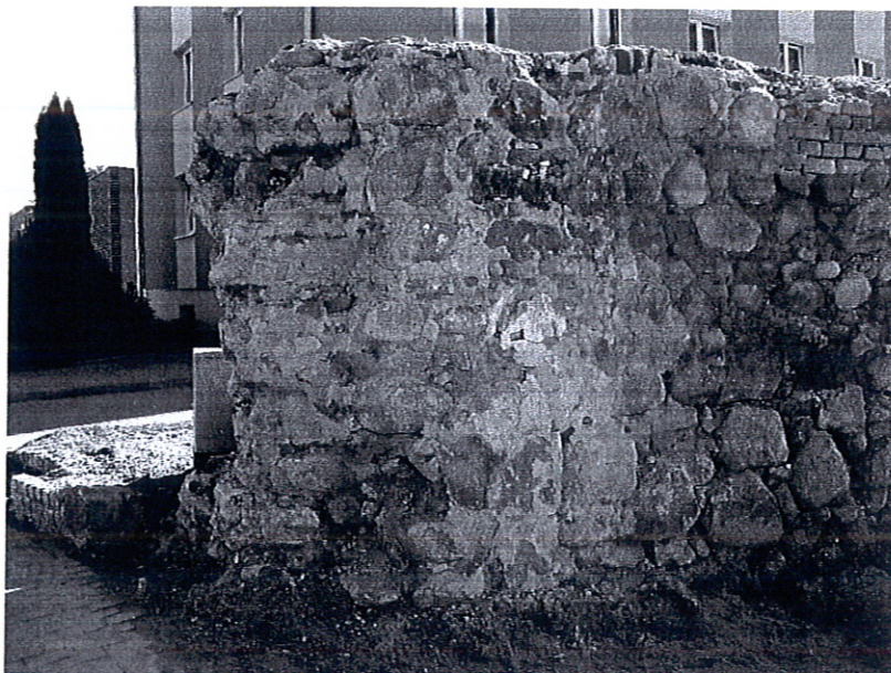
Fot. nr 8. Końcowy fragment muru od strony północnej. Widoczne ubytki w konstrukcji muru i degradacja zaprawy wapiennej. Zniszczone lico kamienne.
