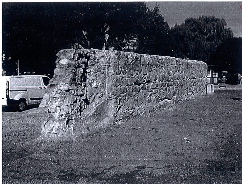
Fot. nr 3. Widok muru od strony południowej. Końcowy fragment w złym stanie technicznym. Widoczne uzupełnienia spoin zaprawą cementową.
