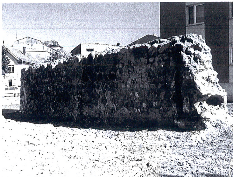
Fot. nr 1. Widok muru od strony zachodniej. W tle widoczna ul. Świętojańska oraz budynek mieszkalny wielorodzinny. Czarny pionowy ślad to pozostałość sadzy po istniejącym w tym miejscu kominie dymowym rozebranego budynku.
