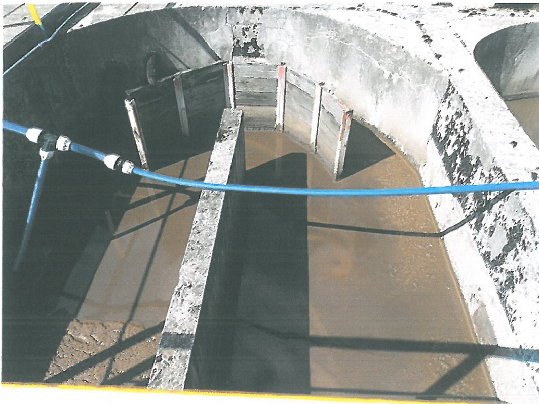
Zdjęcie 4-3 Komora defosfatacji
