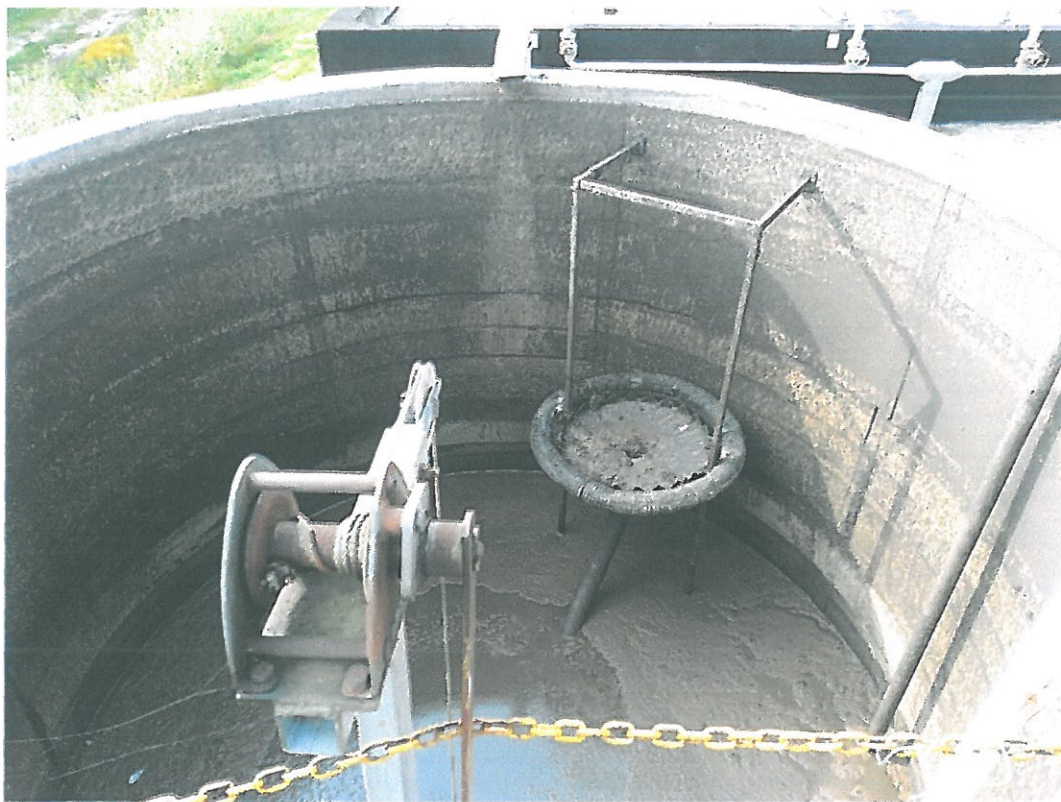
Zdjęcie 4-9 Komora stabilizacji osadu.
