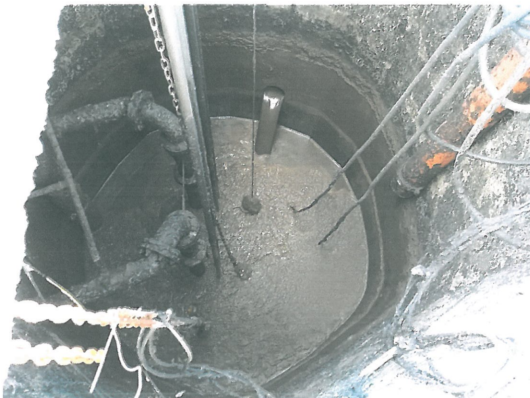
Zdjęcie 4-8 Pompownia osadu.
